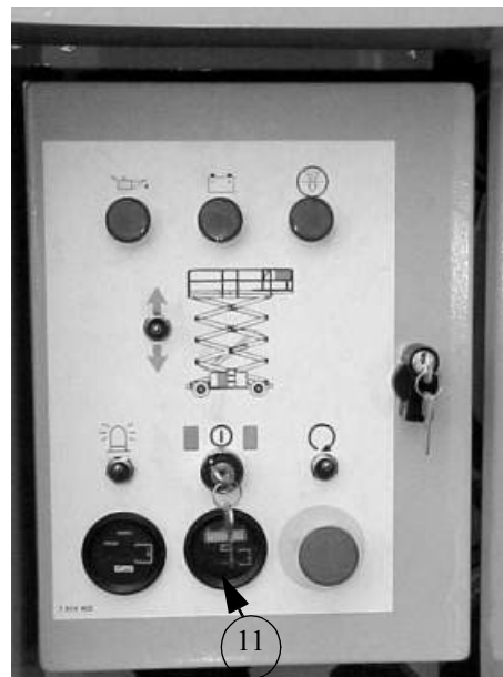
Führerstand Aufbau 2 Energiequellen
